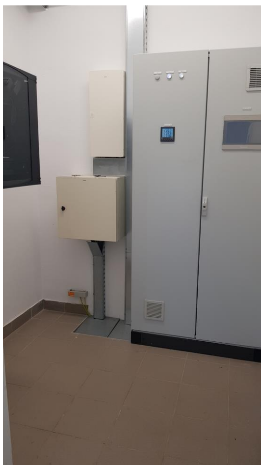
Rys. 2.7. Rozdzielnia wraz z aparaturą sterowania elektrycznego urządzeń OS Rychnów
